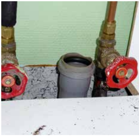
Abbildung 3: trockengefallener und verschmutzter Bodenablauf
