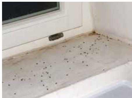
Abbildung 6: Ansammlung abgestorbener Schmetterlingsmücken an Kellerfenster
