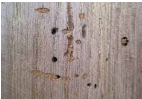
Abbildung 4: Die alten Laubholzbalken im Erdgeschoß wiesen zahlreiche Fluglöcher und Fraßgänge holzbewohnender Käfer auf.
