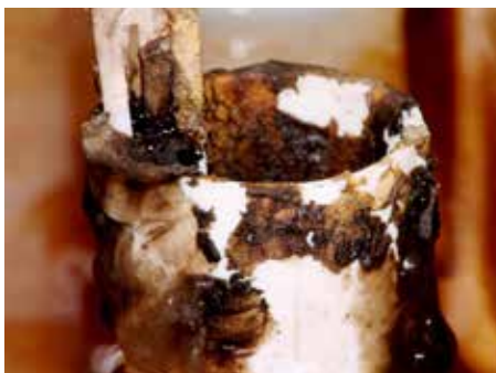
Abbildung 5: Biofilm an der Heberglocke in einem Toilettenspülkasten
