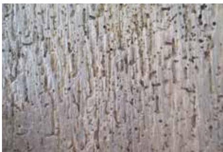
Abbildung 6: Auch die Eichenbalken im Obergeschoß des Hauses wiesen zahllose Fluglöcher und Fraßgänge holzerstörender Käfer auf.
