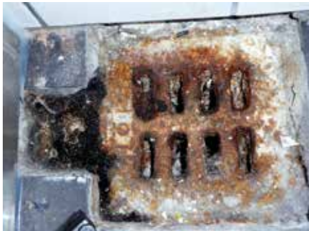
Abbildung 4: nach Rückbau in Installationschacht offengelassener Abwasseranschluss
