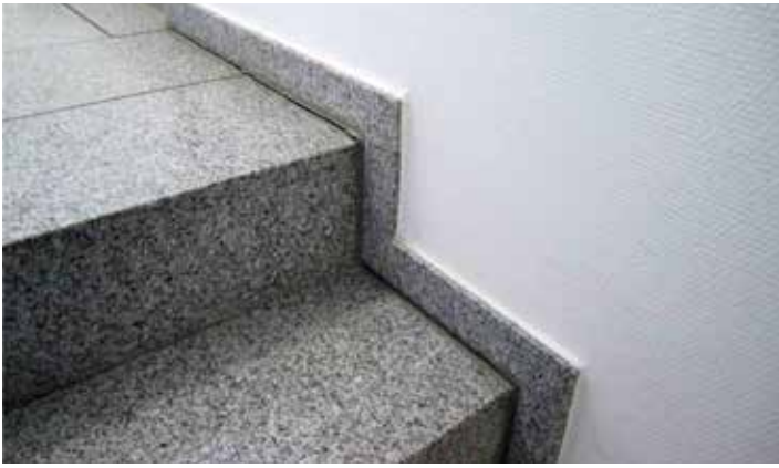
Abbildung 9: Im Treppenhaus fielen zahlreiche Silikonnähte auf, die sich abgelöst hatten oder große Risse aufwiesen
