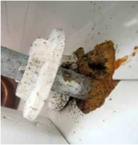
Abbildung 1: Im Bereich einer Versorgungsleitung entlang der Fensterfront wurde in einer der Gemeinschaftsküchen viel Schabenkot gefunden
