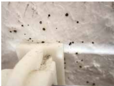
Abb. 9: Bettwanzenkot an einer Wand im Dachgeschoß des Hauses.
