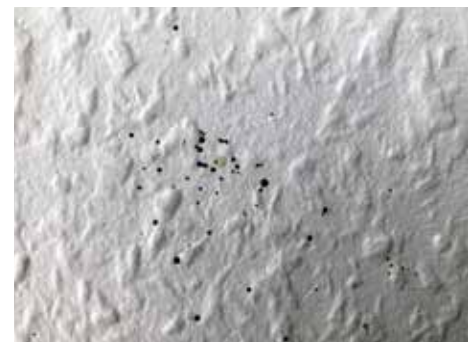
Abb. 7: Bettwanzenkot an einer Wand von Schlafzimmer Nr.2 (im 1. OG).
