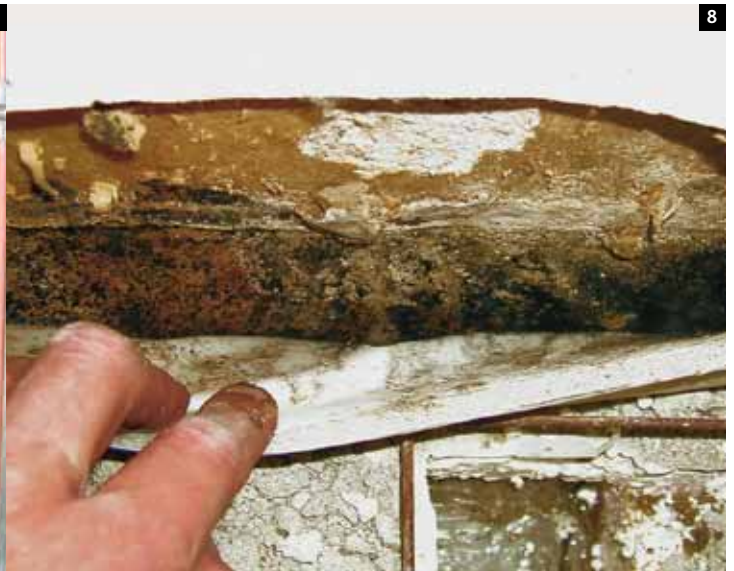
Abb. 8: Für einen objektspezifischen Befall wie diesen hinter einer Fußleiste lässt sich eine Gefährdungsbeurteilung erstellen mit geeigneter Software.
