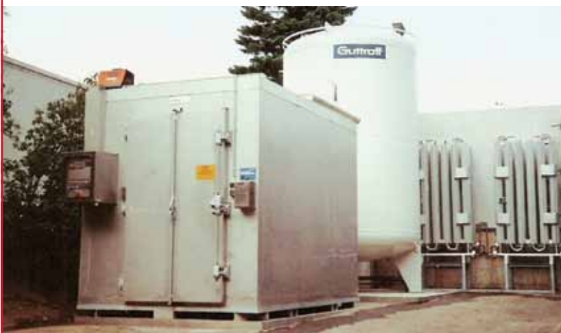
Abb.1 Kaltentwesungskammer mit Tank
